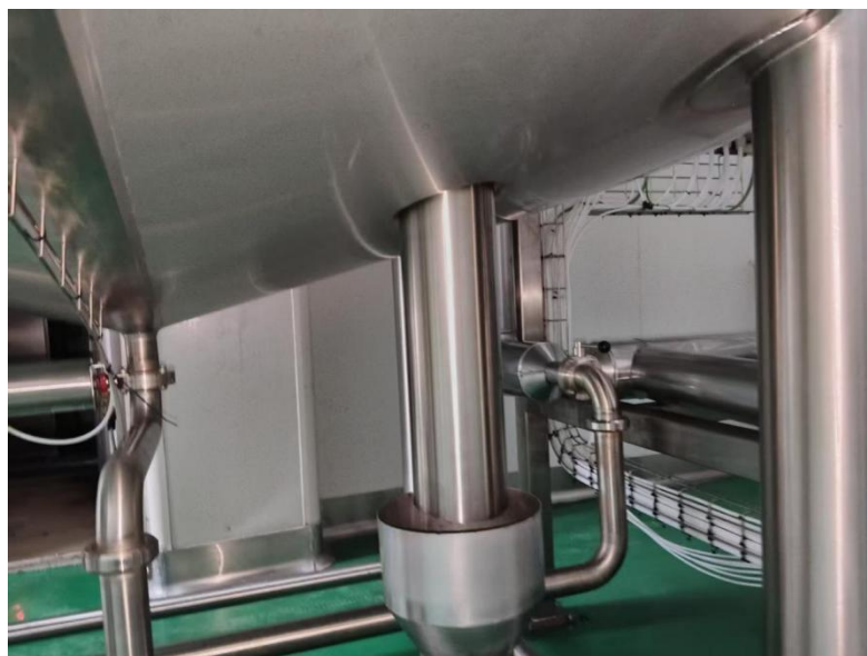
图 2-7 碱性酸雾吸收装置
