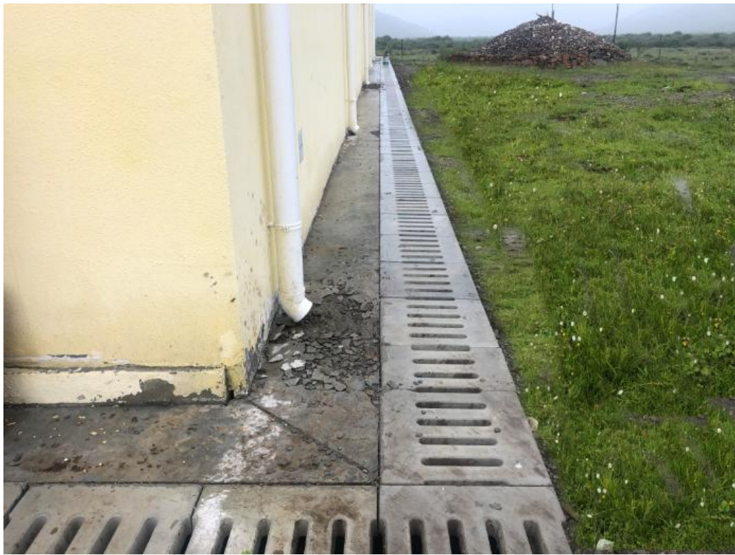
图片 4 建设地块周边设置的盖板排水沟
